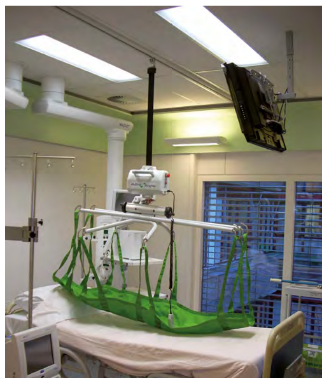
Multirail moteur levage horizontal et monorail aux soins intensifs.
