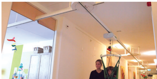
Système monorail avec rotonde et passage de porte coupe-feu.
