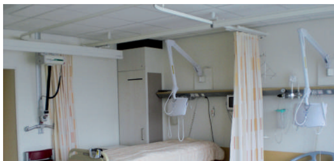
Chambre d'hôpital à plusieurs lits avec système à traverse équipé d'un passage de rideau.
